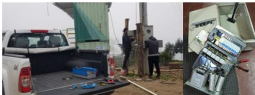
Figura N°79: Mantenimiento eléctrico cambio de componentes eléctricos
