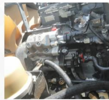
Figura N°28: Cambio de la bomba de inyección
